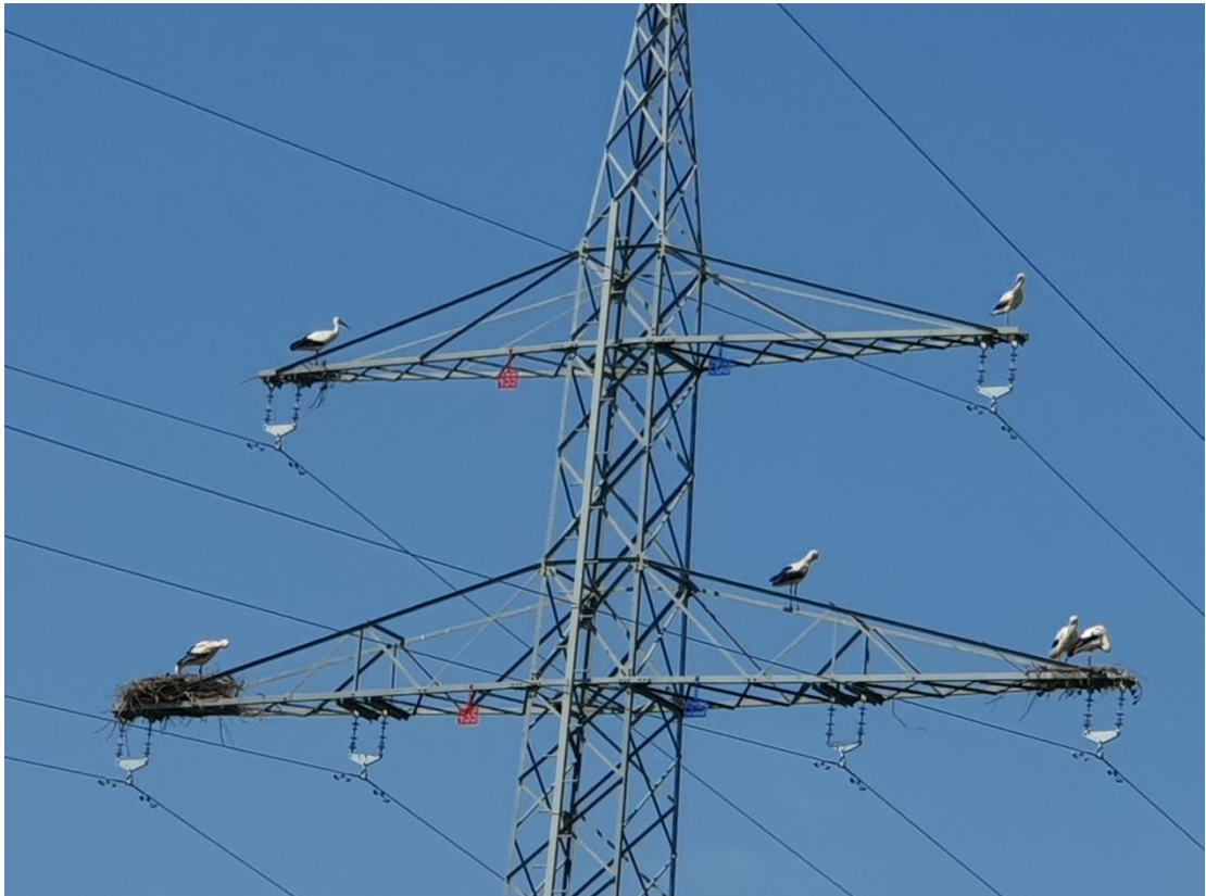
Der Leitungsmast 13 in den Mindener Wiesen am Mittag des 2. Mai mit dem Nest Rodebeck IV auf der unteren westlichen Traverse (links unten), dem Nest Rodenbeck VIII auf der unteren östlichen Taverse (links unten) und den Beginn des dritten Nestbaus auf diesem Mast auf der oberen westlichen Traverse (links oben). Foto: Willi Kamper.
